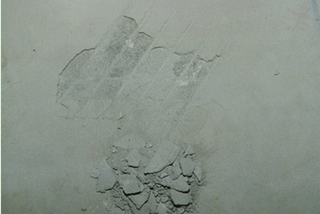
Foto 2 schollenförmig hatte sich die Spachtelmasse vom Untergrund abgelöst
