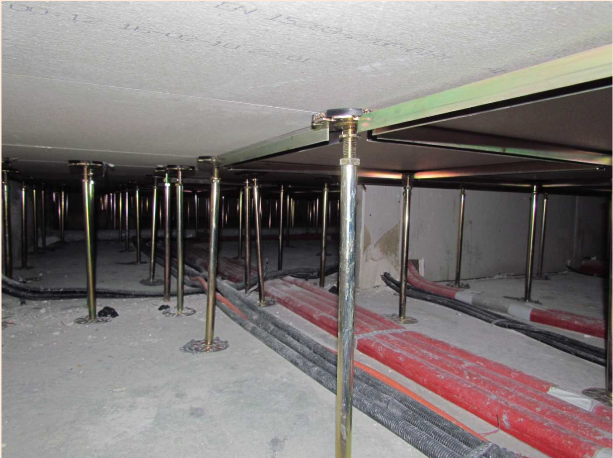
Foto 2 Blick unter den Fußboden eines Wohnzimmers. Die Metallstützen tragen über die Auflageteller die Doppelbodenelemente.
