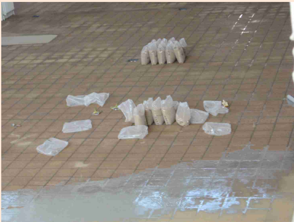
Foto 2 alte Fliesenebene, teilweise grundiert und abgeworfen
